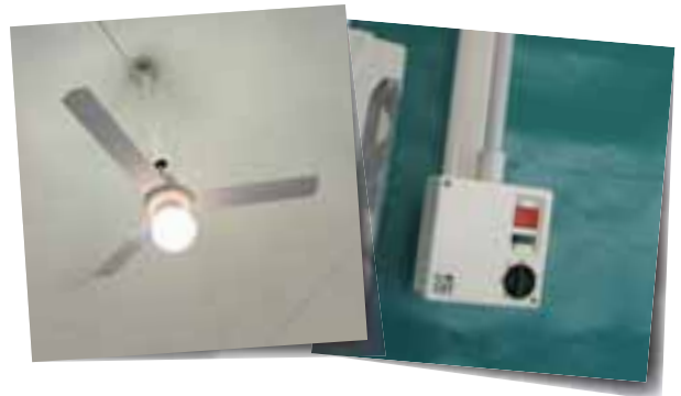
Refreshing system Sistema di ventilazione
